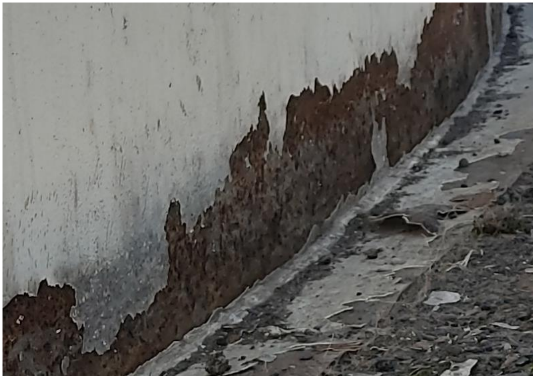
Рис. 1. Коррозионное поражение уторного шва
